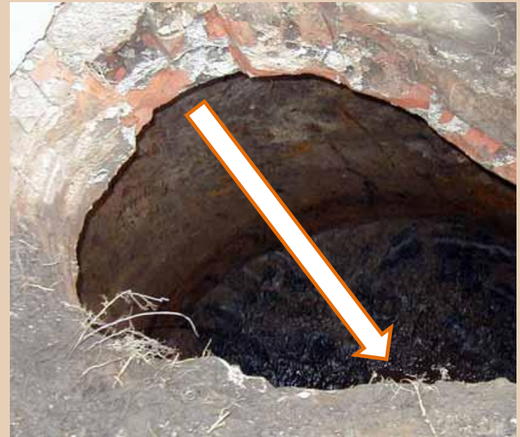
Cisterna rota foto tomada de una cisterna en Israel
